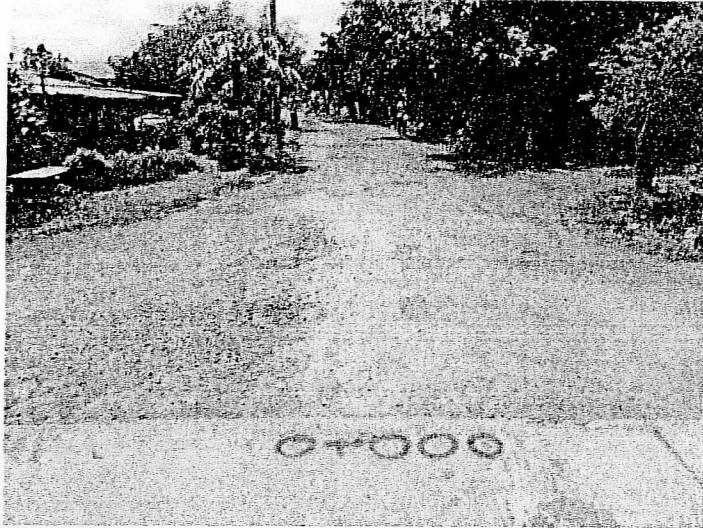
รูปแสดงที่ 5 สถานที่ก่อสร้าง เมื่อดำเนินการก่อสร้าง
